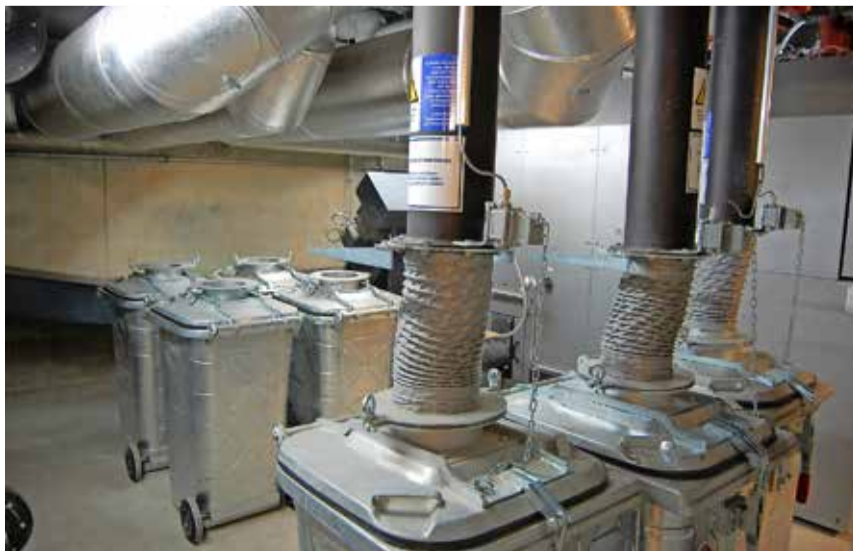
Blick ins Innere der Benkemer Heizzentrale.
