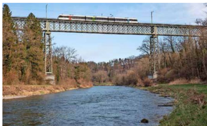
Die Thurbrücke bei Ossingen bleibt bis auf Weiteres gesperrt.
